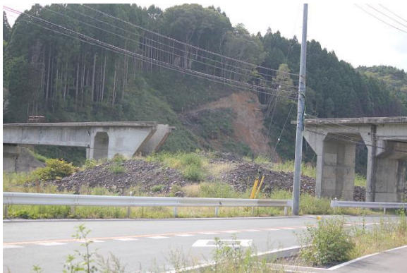
JR清水橋。コンクリート部分は残っているが、盛土部は津波にさらわれて無くなっている。
