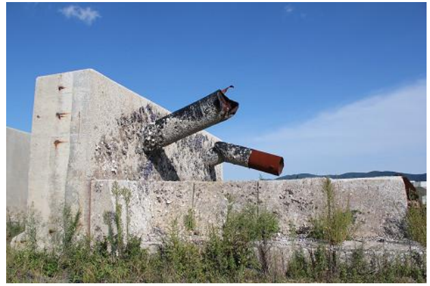
φ 700mm の鋼管杭が破断された離岸堤
